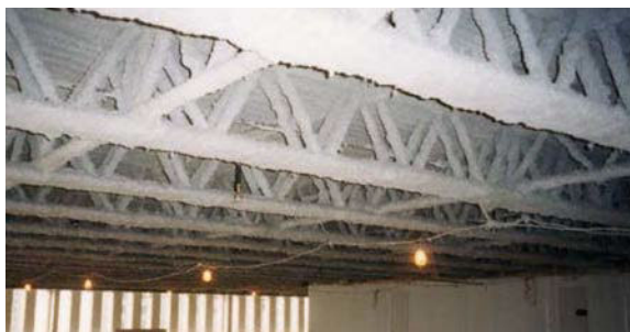
Ein Foto der WTC-Träger mit Brandschutzbeschichtung.
