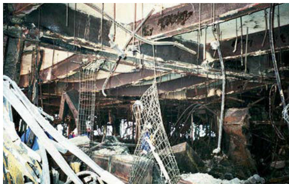
Brandschaden in WTC 5 (NIST-Studie von 2002 über Brände, die zu teilweisen oder völligen Einstürzen führten)
